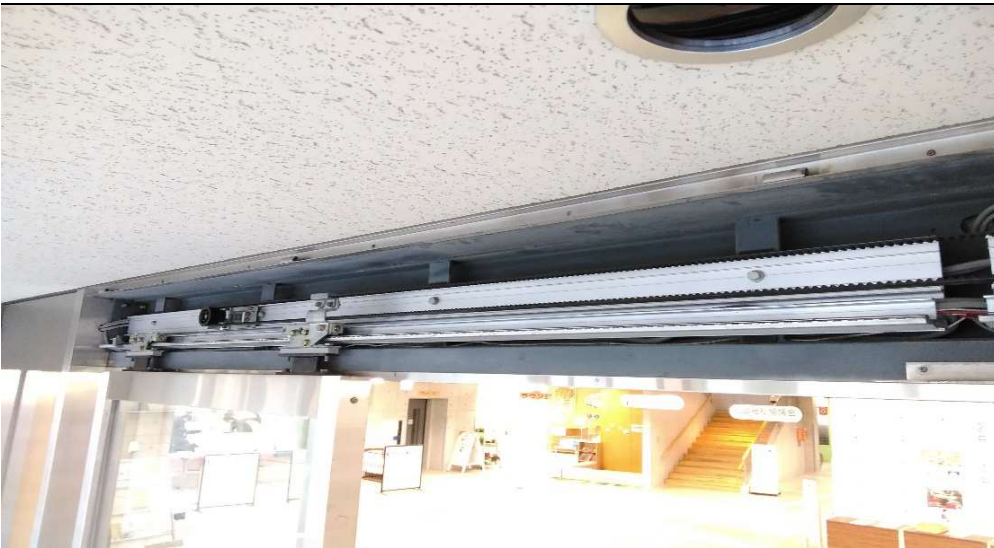
自動ドア開閉装置（装置取付状態）
