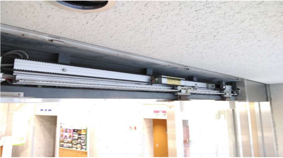
件名：菊川市総合保健福祉センタープラザけやき 自動ドア開閉装置（装置取付状態）
