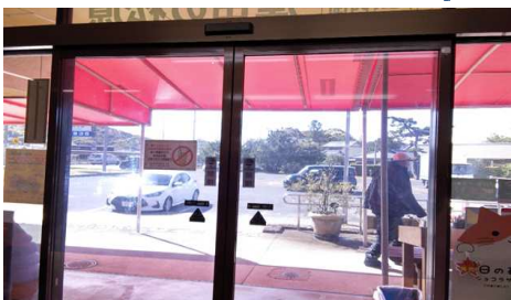
③老朽化自動ドア装置
