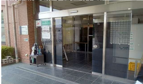
②自動ドア開閉装置(内観)
