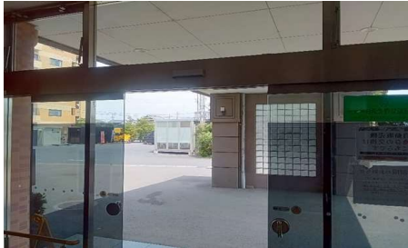
③老朽化自動ドア開閉装置
