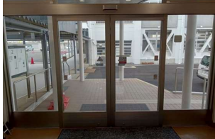
③ 老朽化自動ドア装置
