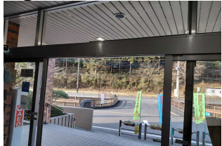
③老朽化自動ドア装置
