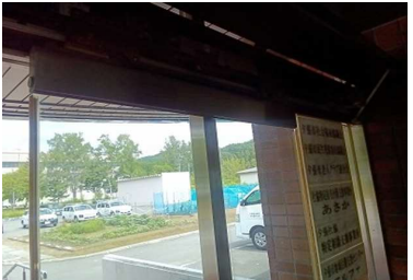
③老朽化自動ドア装置
